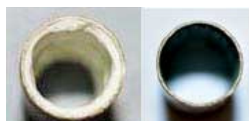
Dépôts calcaires dans une conduite d'eau avant la pose de l'activateur d'eau, puis quelques semaines après
